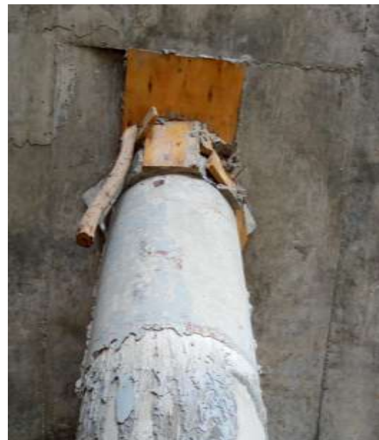
(d) Forms stuck on concrete surface
