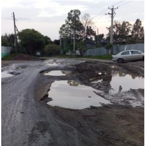
(d) Damage and unsafe road to users
