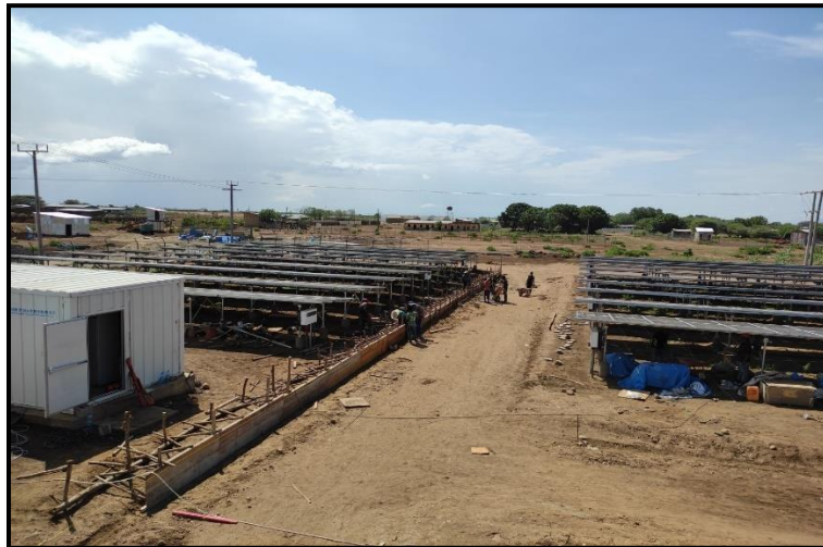
Figure 3.3 Omorate 375 kW solar mini grid
