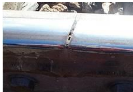
(d) Endpost battering/ delamination
