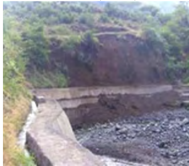
(d) Irrigation canal affected by the landslide (Mersa).
