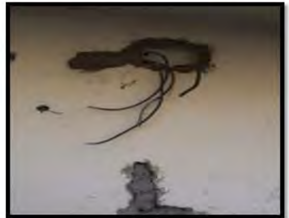
(d) Exposed electrical wire on floor area
