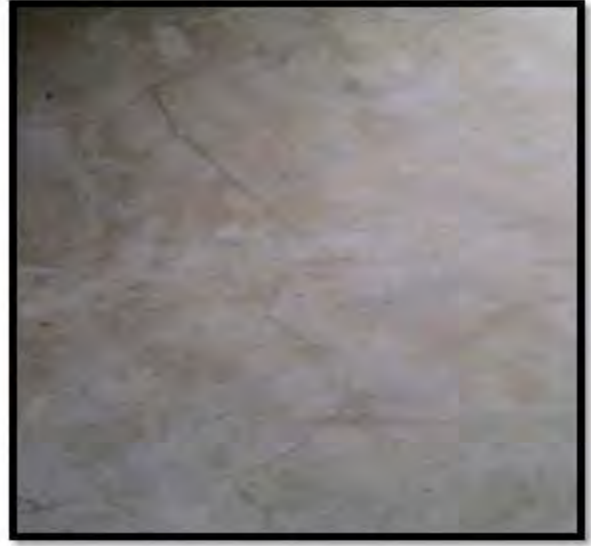
(d) Cracks seen at floor slabs
