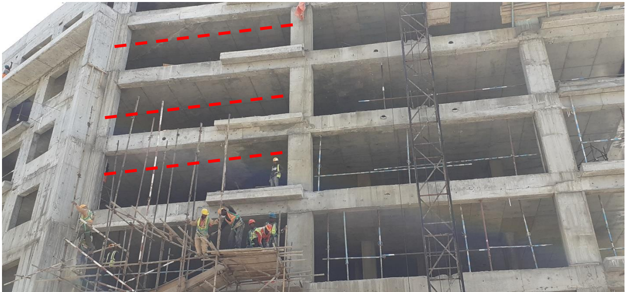
No Edge protection Barricade
